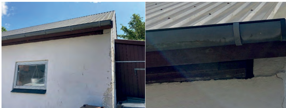
Figur 3-8 Tilbygning har åbninger under tagrenderne flere steder. Foto taget i retning mod øst.
