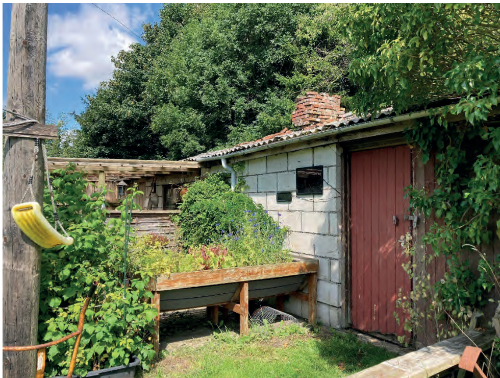
Figur 3-25 Værkstedet havde et åbent vindue, samt huller i murværket
