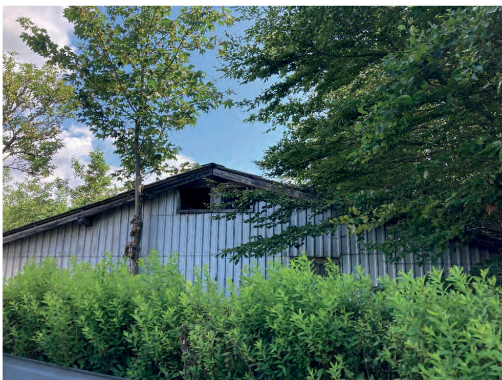
Figur 3-9 Ladebygningen bag hovedhuset har åbninger i tagkonstruktionen. Foto taget i retning mod øst.
