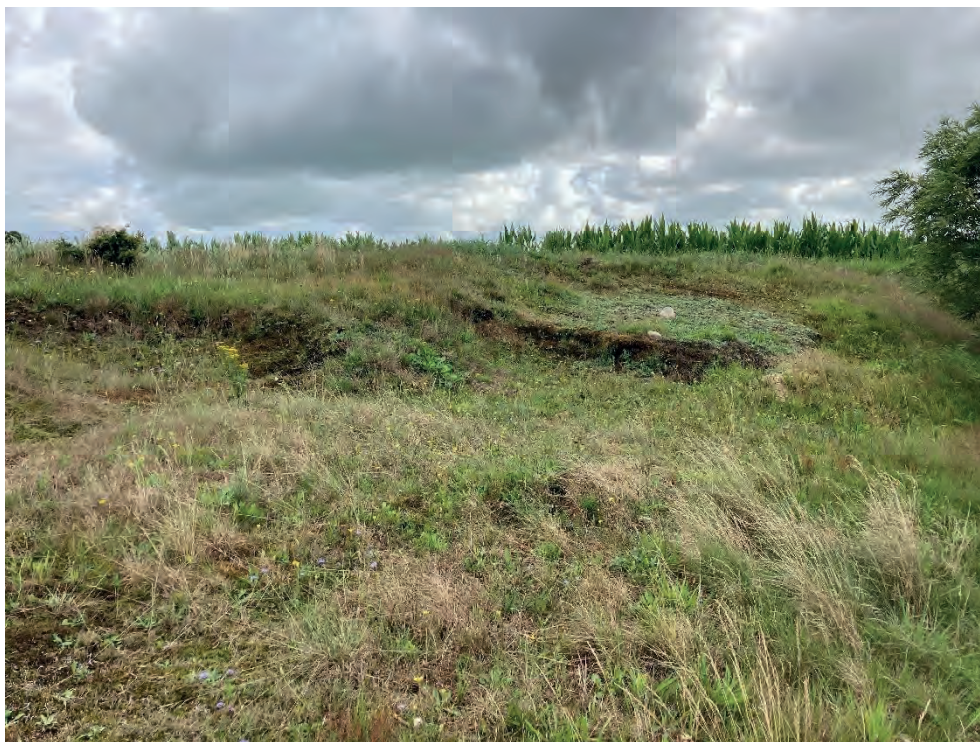
Figur 4-5 Markfirbensegnet skråning med løst sandet jord og lav vegetation nord for E20S.
