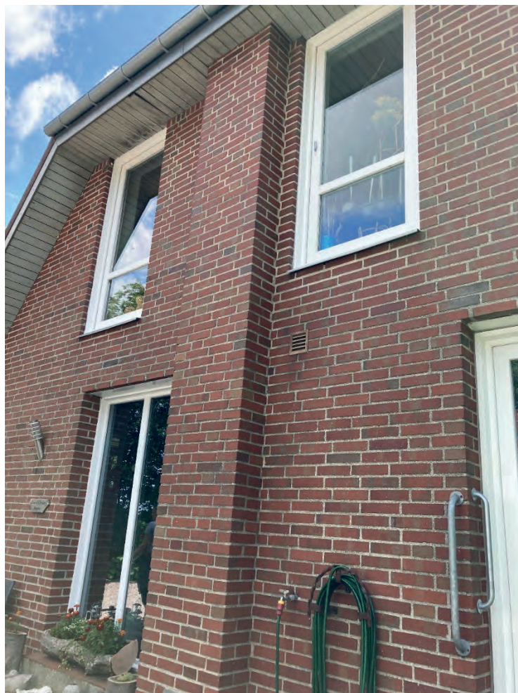
Figur 3-29 Hovedhusets murværk var intakt, men der var sprækker samt løst brædder ind under tagkonstruktionen
