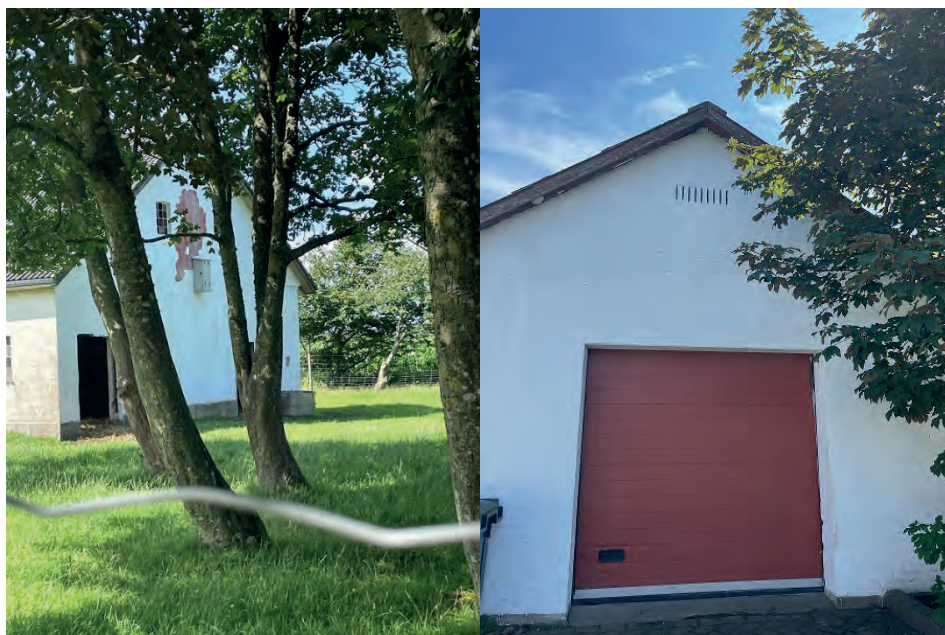
Figur 3-11 Foto tv. viser staldbygning med åbne staldvinduer i kvisten. Foto taget i retning mod nordvest. Foto th. viser Garage med sprækker i kvisten. Foto er taget i retning mod syd.
